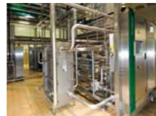
Die neue Kurzzeiterhitzungsanlage VarioFlash B von KRONES.
